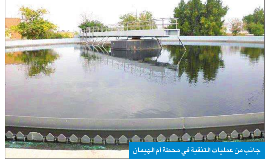
إحدى غرف عمليات المعالجة في المحطة
