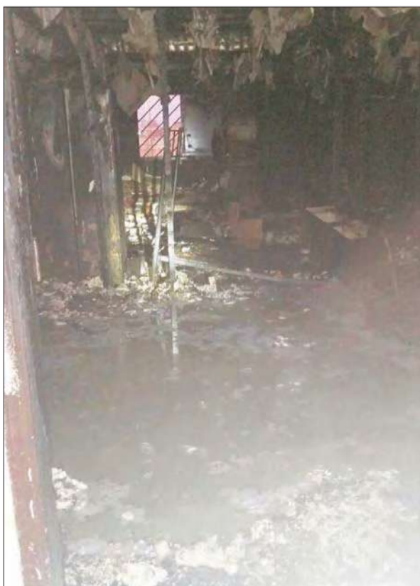
آثار الحريق في الشقة
