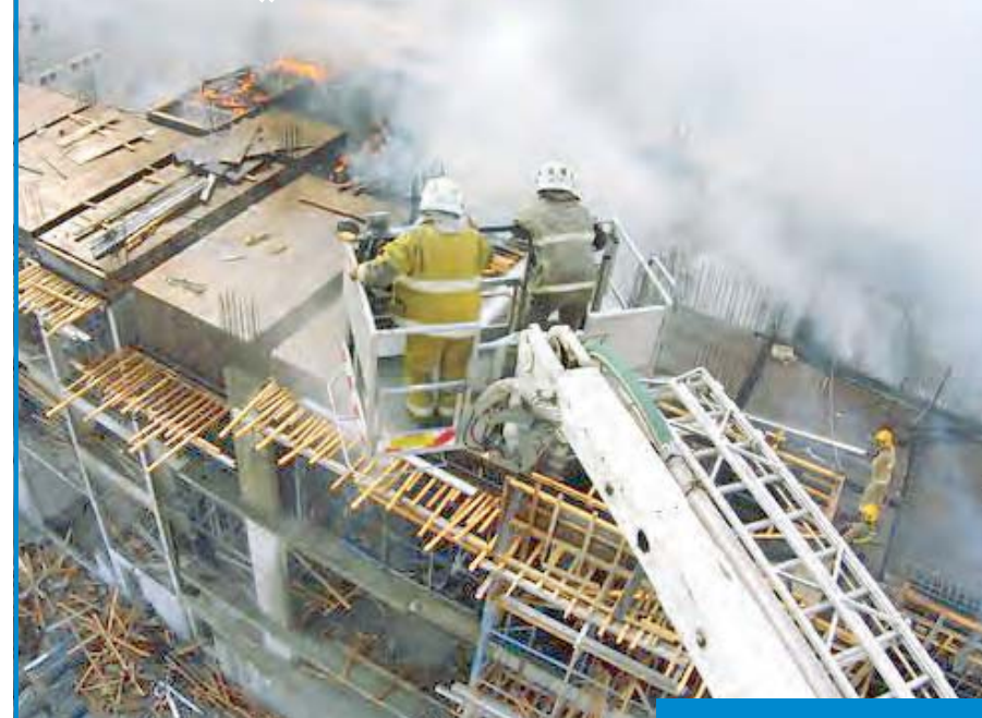
رجال الإطفاء يكافحون الحريق
