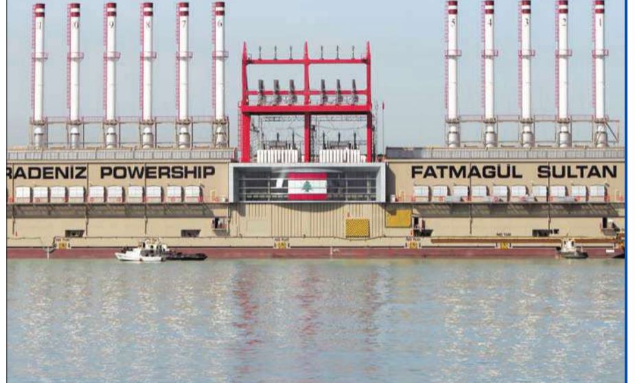
سفينة «السلطنة فاطمة غل»، التركية المنتجة للطاقة الكهربائية ترسو أمام معمل الذوق لإنتاج الطاقة الكهربائية. وستمكث السفينة قبالة بيروت ثلاث سنوات حيث ستمد لبنان بـ 270 ميغاوات (أ ف ب)
