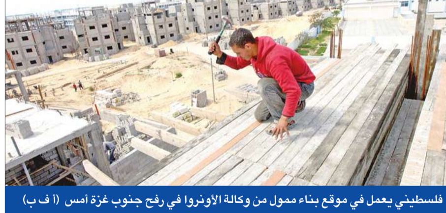
فلسطيني يعمل في موقع بناء ممول من وكالة الأونروا في رفح جنوب غزة أمس (أ ب)
