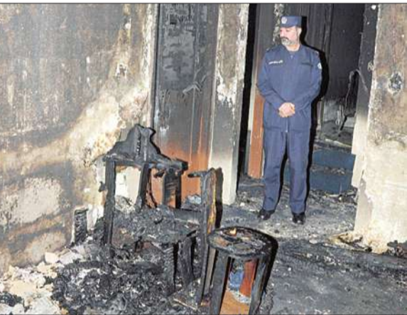
آثار الحريق في المنزل
