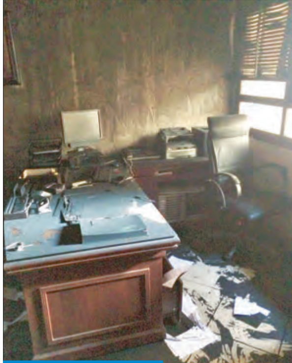
آثار الحريق في مبنى المدرسة
