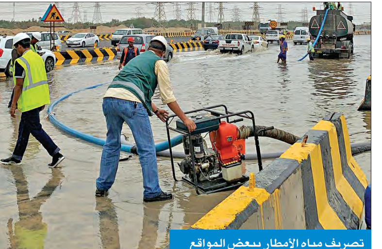
تصريف مياه الأمطار ببعض المواقع
