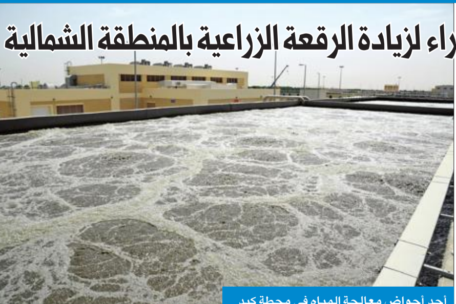
أحد أحواض معالجة المياه في محطة كبد
