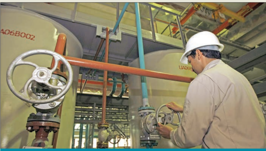
إحدى منشآت الطرد المركزي المعروفة في إيران بـ"محطة تخصيب الوقود" الواقعة تحت الأرض
