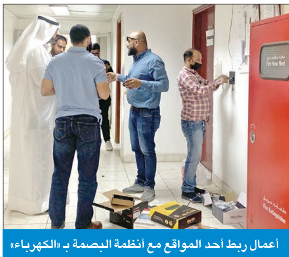
أعمال ربط أحد المواقع مع أنظمة البصمة بـ «الكهرباء»
